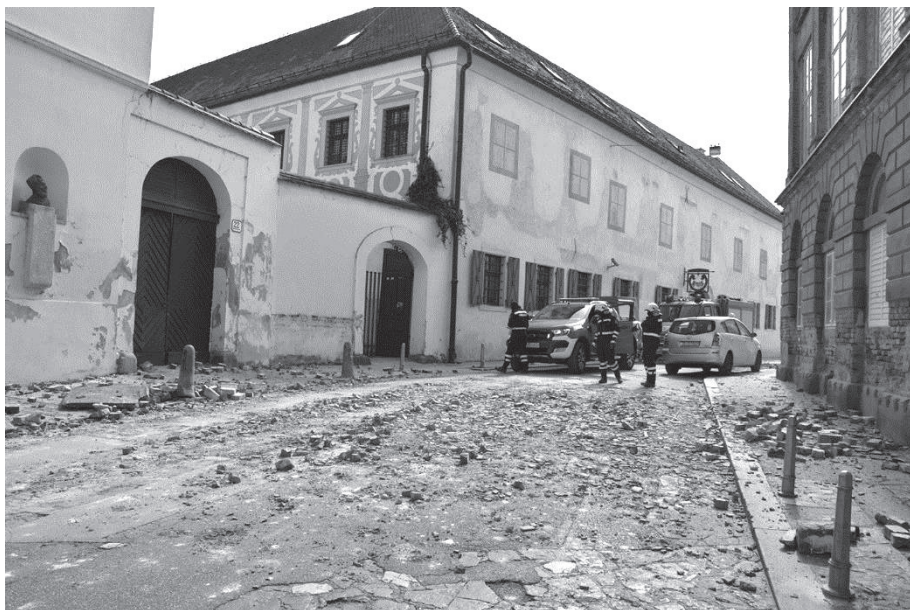
Slika 4. Posljedice potresa 22. ožujka 2020. na Opatičkoj ulici u Zagrebu
