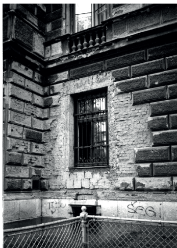
Slika 2. Popravak prozora na Depou 1 nakon pogotka granate tijekom rata u Bosni i Hercegovini 1992. – 1995.
