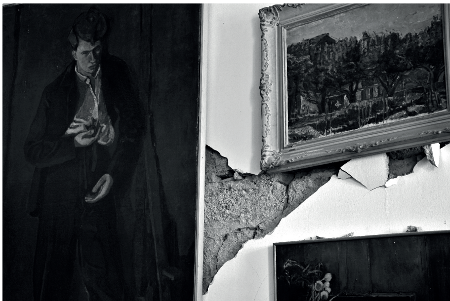
Slika 6. Umjetničke slike na oštećenim zidovima
