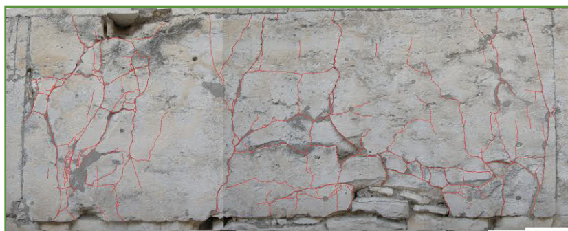
Prikaz pukotina na bloku 53 (Foto, obrada i prikaz pukotina: Đ. Gobić-Bravar)
